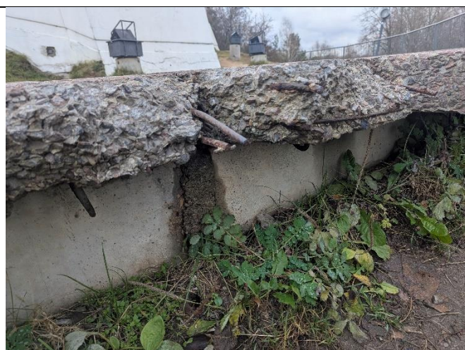
19 pav. Pavojingai atsikišusi aikštelės plokščių armatūra – galima susižeisti.
