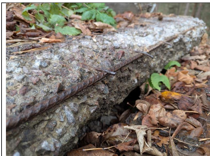
22 pav. . Pavojingai atsikišusi laiptų plokščių armatūra – galima susižeisti.
