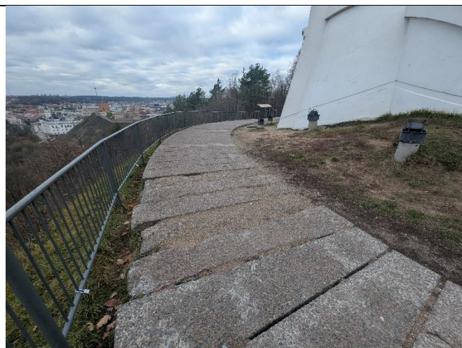
17 pav. Trijų kryžių paminklo apžvalginės aikštelės plokštės ištrupėjusios, tarp plokščių atsiradę plyšiai. Tvorelė sumontuota šalia aikštelės, galima įkristi į tarpą, tvorelės aukštis neatitinka LST reikalavimų.
