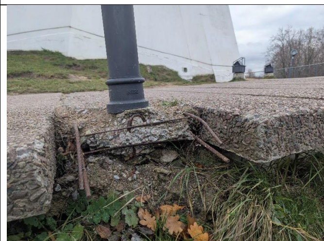
18 pav. Nutrupėjęs apsauginis aikštelės plokščių betono sluoksnis, korozijos pažeista armatūra.
