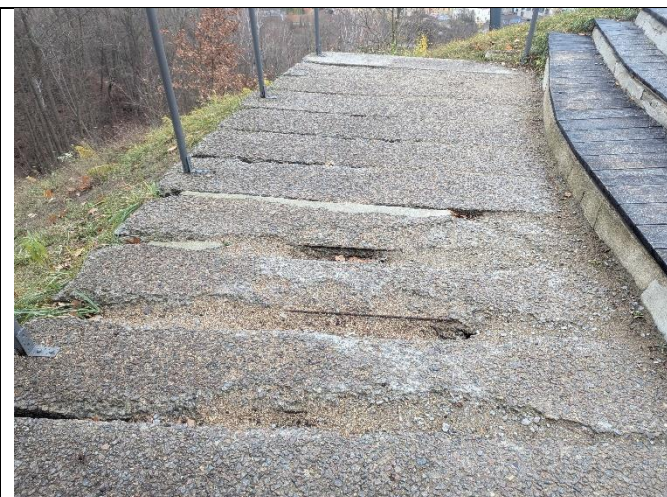
16 pav. Trijų kryžių paminklo apžvalginės aikštelės plokštės ištrupėjusios, tarp plokščių atsiradę plyšiai.
